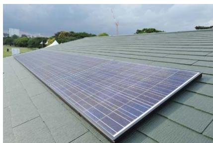
左上／太陽光発電パネル。左中／太陽光発電パネルによる発電量や売電量、CO 2 削減量は、カラー電力モニターでチェック。使用電力目標の達成率も確認でき、見ることで環境意識が高まる。右下／コロナ製のデザインエコキュートのヒートポンプユニット(左)と貯湯タンクユニット(右)。左下／シャープ製のIHクッキングヒーター。
